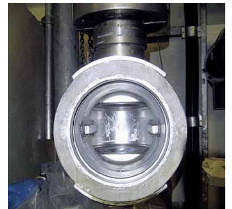
Geöffnete Armatur eines Volumen-Regelsystems nach der Dekontamination
