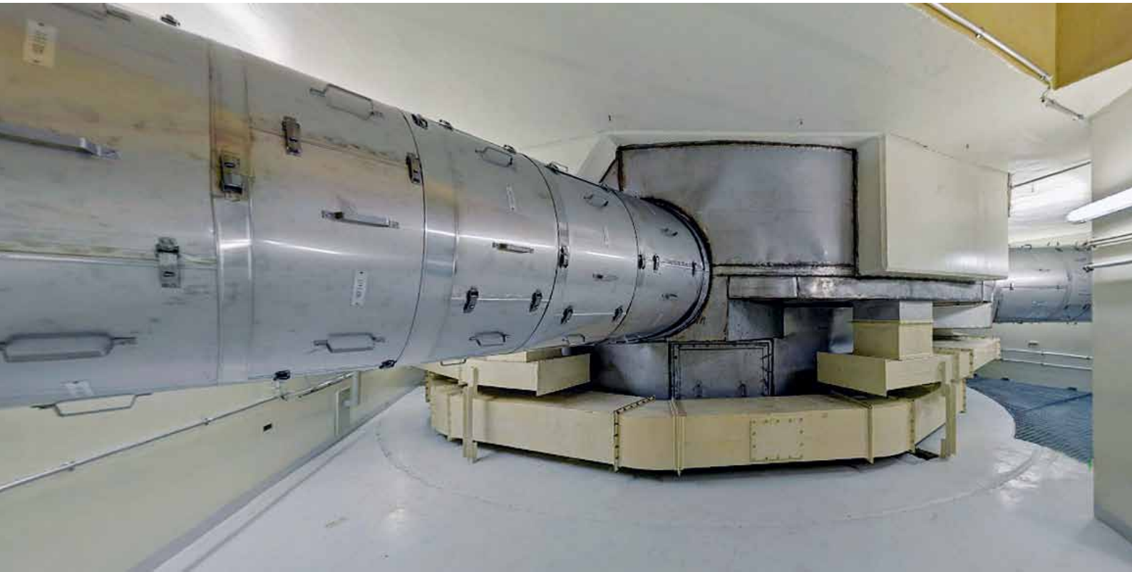
Eine der acht Hauptkühlmittelleitungen im KKW Biblis mit über 1 m Durchmesser: Die Rohre des heißen Strangs leiten das auf knapp 300 °C im Reaktor erhitzte und unter 155 bar stehende Wasser zu den Dampferzeugern. Sie wurden zum Teil durch die Neutronenstrahlung aus dem Reaktorkern aktiviert
