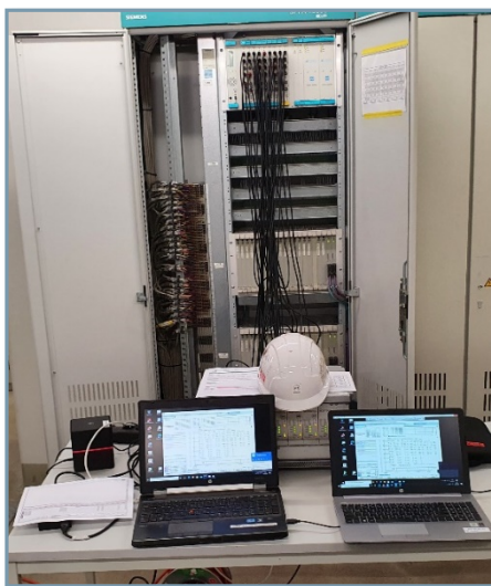
Sicherer Anschluss an vorhandene Schaltschränke
